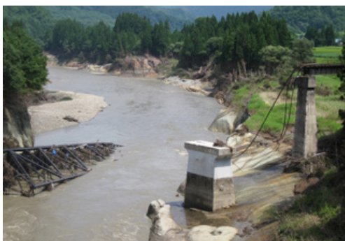
(1) 橋脚が流失した第7只見川橋りょう
